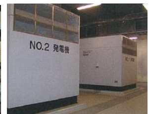
■非常用発電機イメージ
