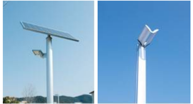
ソーラーパネル・LED照明採用による環境への配慮
